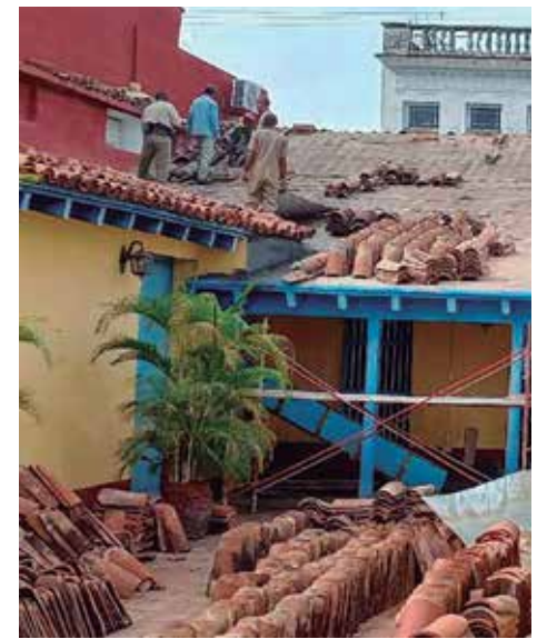
Todo el tejado se levantó para eliminar los orificios en la madera del techo.
