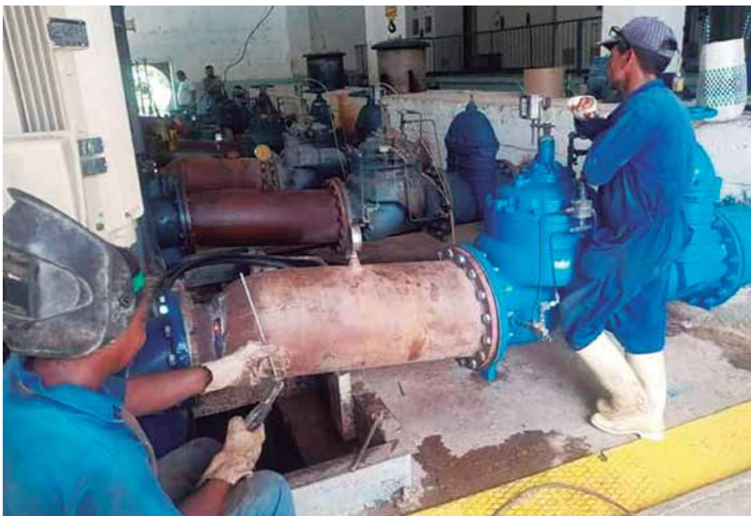
Los trabajos incluyeron adaptaciones, labores de pailería, protecciones eléctricas, certificación de las instalaciones, entre otros quehaceres. /Foto: Cortesía de la Empresa Provincial de Acueducto
